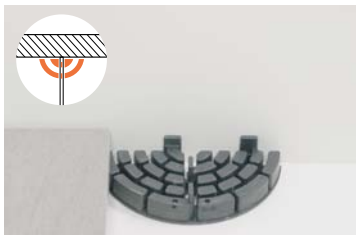
Leg vervolgens de randtegels op de halve dragers. De resterende tegels worden vanuit de hoek gelegd.
